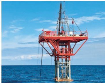
水深35mの地点での鋼製檣を使用したボーリング実施状況。安全施設の追加装備など改良を行ったほか、大型の鋼製檣を開発し、現在水深50mまで対応可能となりました。
