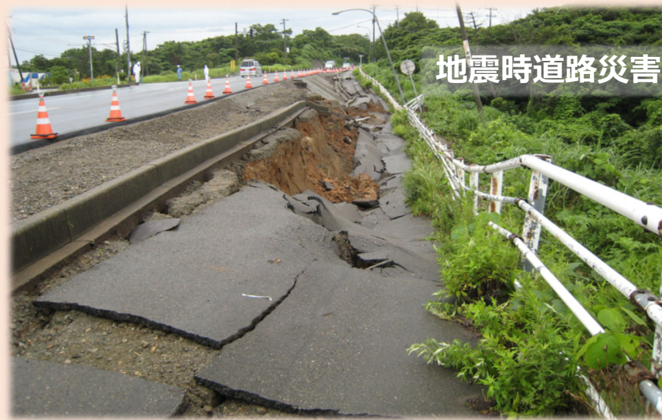
地震時地すべり
