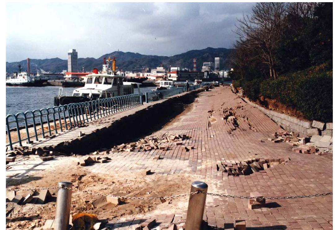
1995兵庫県南部地震による被害状況
