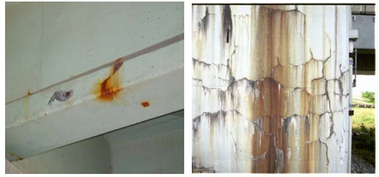
塩害：鉄筋腐食に伴う剥落 アルカリ骨材反応：地図状ひび割れ
